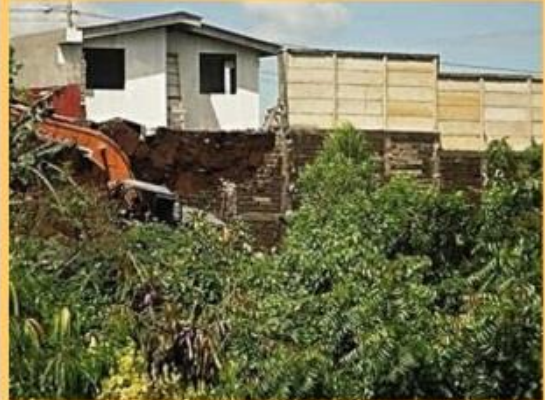
Muro de contención colapsado, Barrio 18 de Mayo
